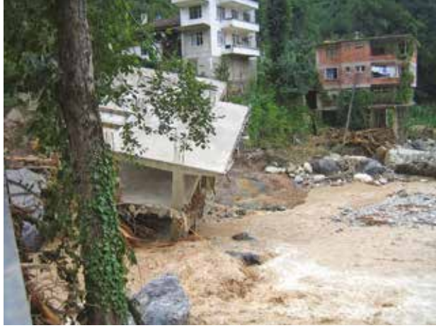
Dere Yatağına Yapılan İnşaatın Sonu
