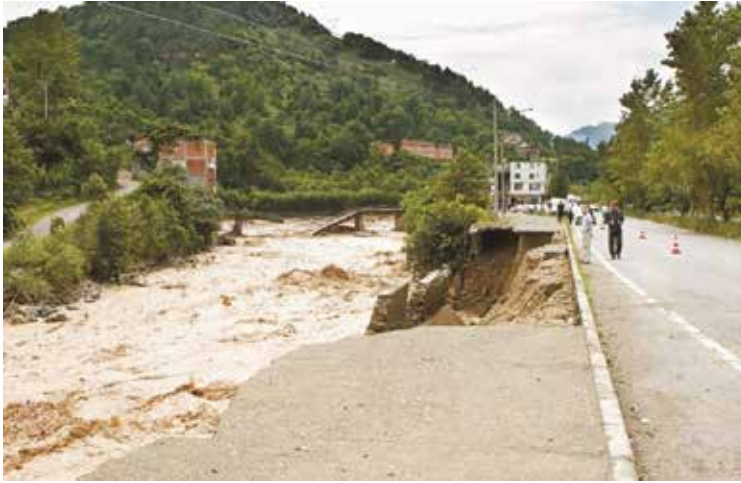
Taşkında Hasar Gören Köprü ve Dere
