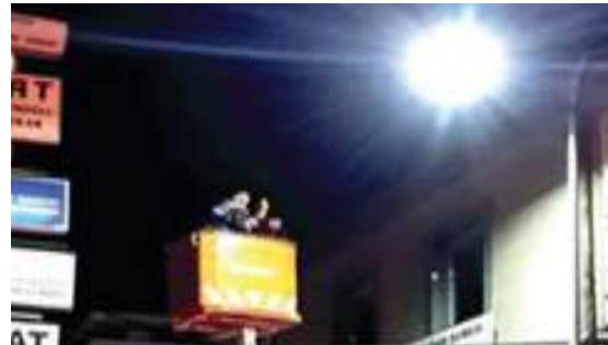
Şehrin ihtiyaç duyulan muhtelif yerlerine aydınlatma ve elektrik bakım onarımları imkanlar ölçüsünde yapılmıştır.
